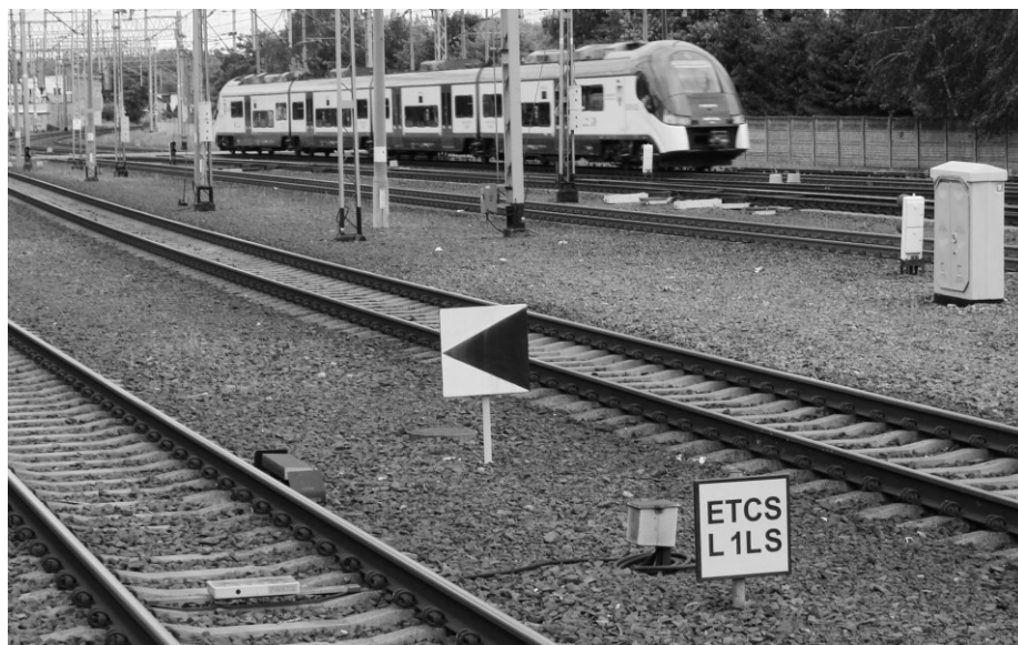
• Jedyny na polskiej sieci kolejowej odcinek, na którym zainstalowano system ETCS Limited Supervision, to linia Poznań – Wągrowiec. Początek odcinka na stacji Poznań Wschód.
