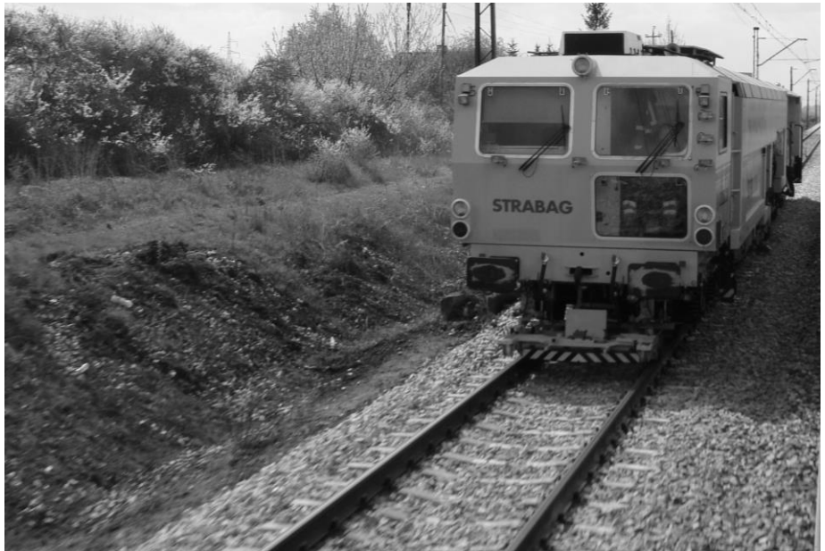
● Maj 2013 r., rewitalizacja odcinka Skarżysko-Kamienna - Radom. Prace remontowe między stacjami Jastrząb i Rożki.
